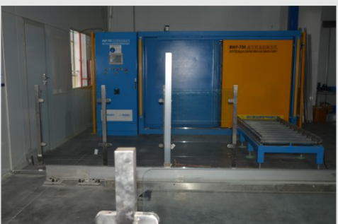
氮检漏及全自动气体充注系统
