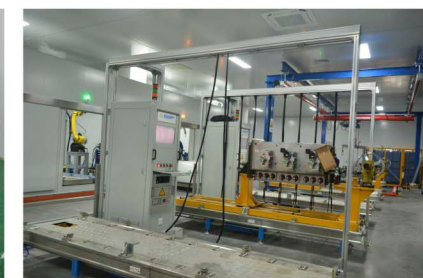
环网柜检测区
